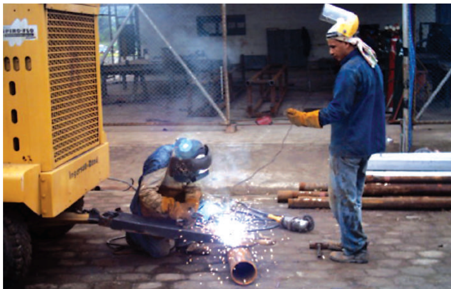
Imagen 1. Procesos peligrosos para el soldador (Fotografía: Ó. Betancourt)
