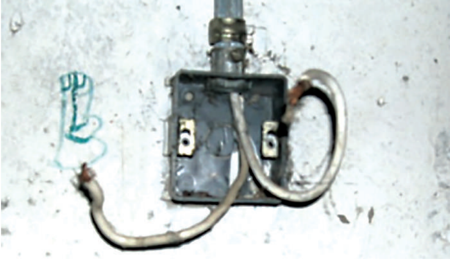
Imagen 2. Alambres pelados-elementos peligrosos (Fotografía: Ó. Betancourt)
